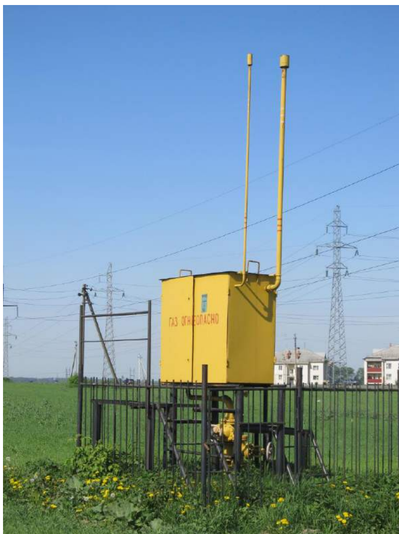
Рисунок 11. Шкафной газорегуляторный пункт.
